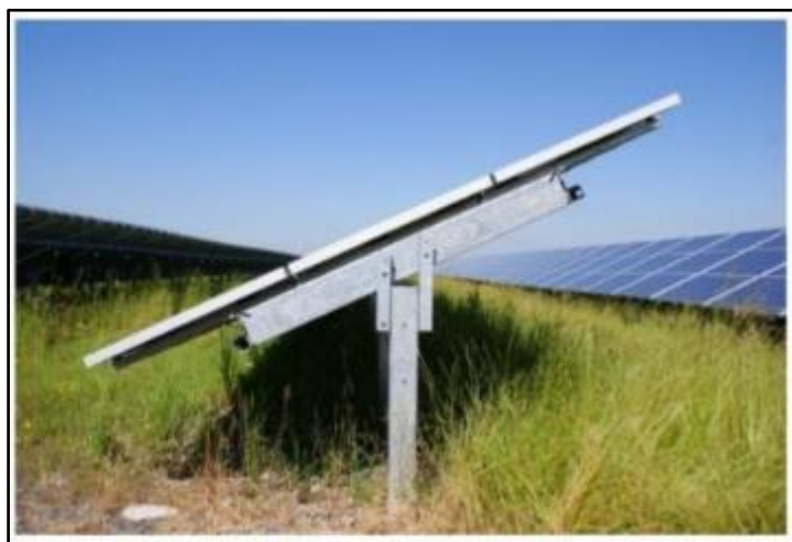
Fotografia 1 Przykładowa konstrukcja wsporcza modułów fotowoltaicznych (źródło: gramwzielone.pl)
